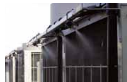
空調室外機への設置例
